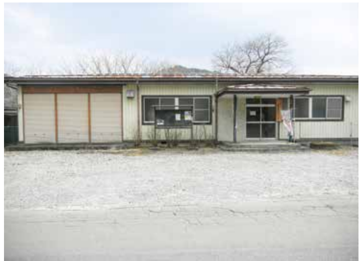
修繕が待たれる猿神農業担い手センター
