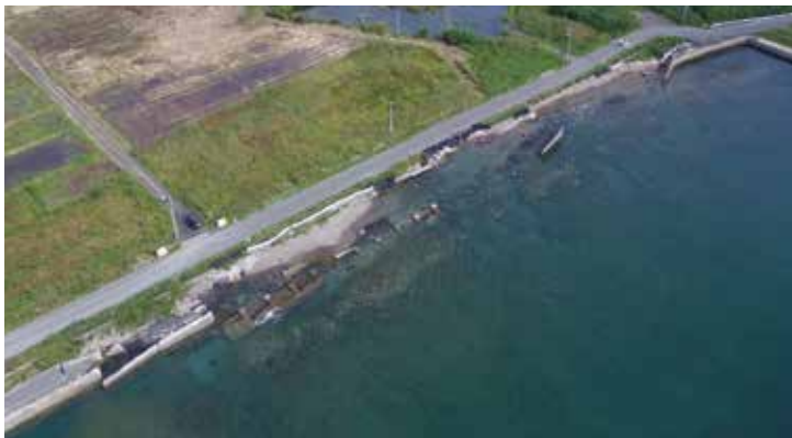
図2-6 浜川目東部防潮堤・海岸道路の破壊 (2015年9月20日撮影)
