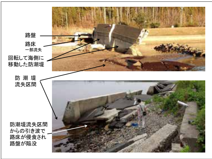
図2-7 浜川目東部防潮堤・海岸道路の破壊状況。
